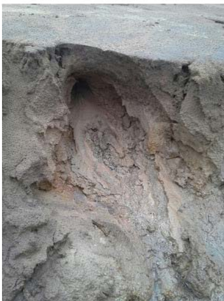
Samma grop som ovan: vattnet tycks delvis ha transporterats under schaktad yta, kanske i djurgångar. Här har det runnit genom en sådan gång och rätt ut i gropen.
