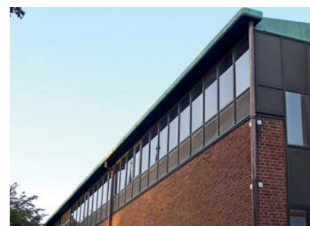
De nedre delarna av fönsterpartierna mot väster har i sen tid ersatts med plåt, liksom på trapphuset intill. 2014.
