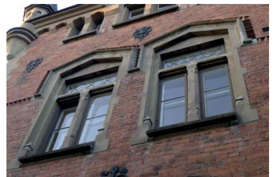
I vissa rum är endast en båge kopplad och inåtgående, medan de övriga är utåtgående med lösa innerbågar. Den kopplade bågen har något olyckligt monterats långt in i fasaden.
