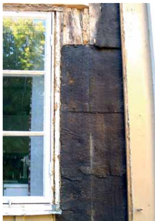
Mellan panel och stomme fanns en mycket hård och kraftig tjärpapp, skuren eller riven i ark, troligen ursprunglig från nybyggnadstiden. Okt. 2013.
