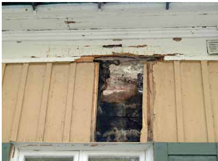
Fukt- och rötskada norr om mittpartiet. Mars 2013.
