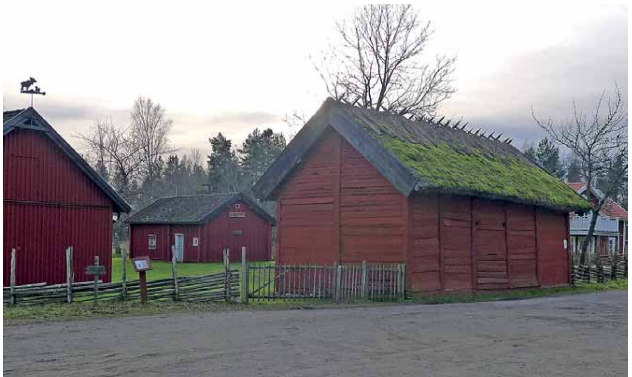
Gluggetorpet från norr med boningshuset i bakgrunden. Ladugårdens norra takfall har blivit kraftigt mossbelupet. Nov. 2012.
