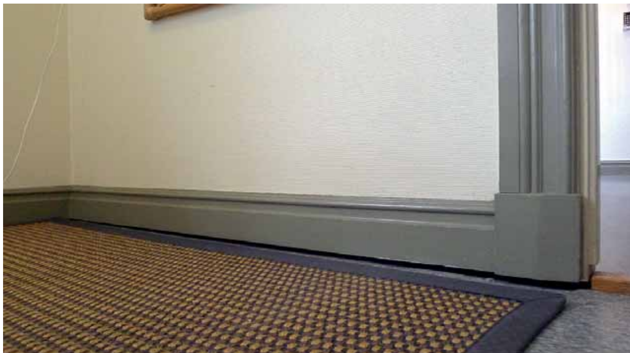
Sättning i golv, bottenvåningen i kapprum/passage 108 mot gården/norr. Febr. 2013.
