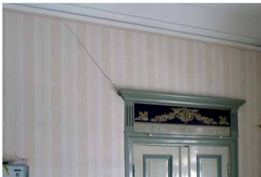
Vänster: Spricka i östra väggens tapet, rummet innanför balkongen mot torget 1 tr. Rummet omtaptserades senare helt. Febr. 2013.
