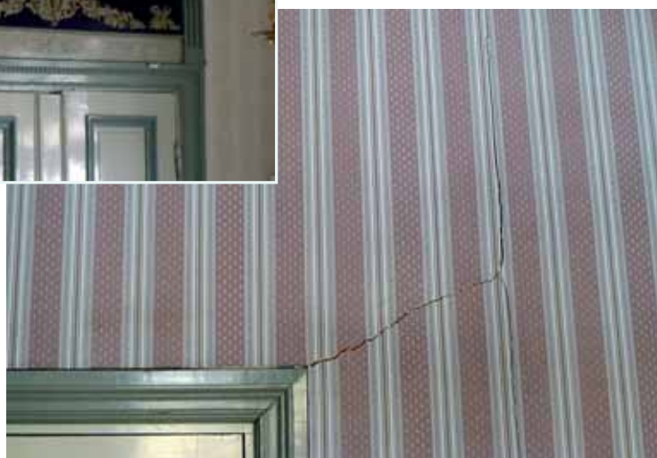
Höger: Spricka i hjärtväggens tapet i vigselrummet, 1 tr. Kåbergstapeten med empireerand från ca 1950, ej längre i produktion, bedömdes för övrigt vara i acceptabelt skick, varför sprickan senare lagades i med limfärger. Febr. 2013.
