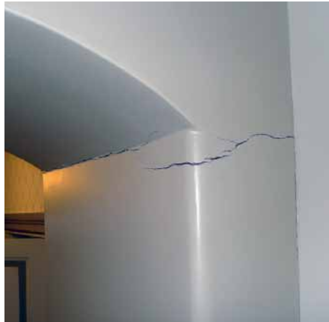
Vänster: Sprickan mellan rådhuset och det ca 100 år yngre fd Televerkshuset. Ovan: Sättnings-skador i murverk på rådhusets botten-våning. Febr. 2013.
