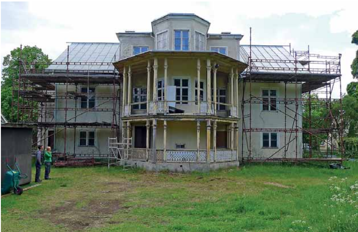
Anden 6 under renovering, gårdsfasaden med det stora veranda-balkongarrangemanget före renoveringsarbetena. Foto juni 2012.
