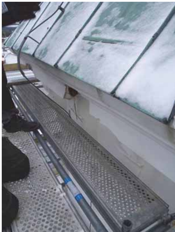
Putsskadorna i anslutning till torntaket. VGM_jenbj8_Tidaholms_kyrka_puts_o_plat_2013-03-13_3.jpeg
