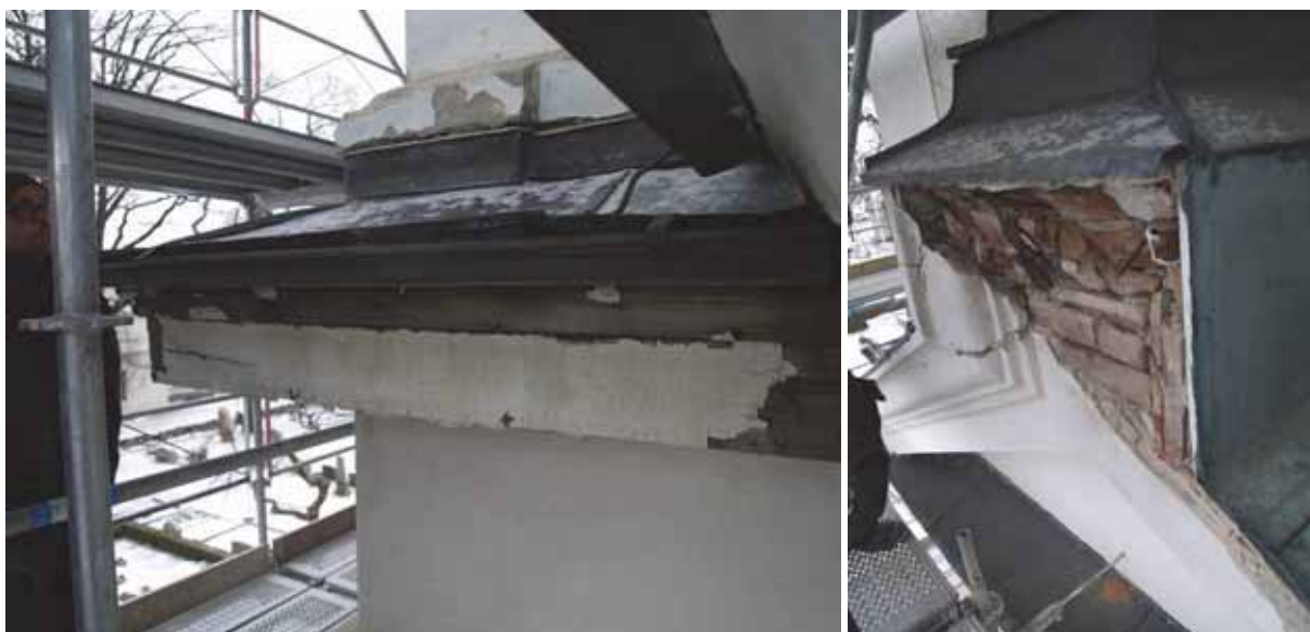
Del av gesimslisten före åtgärderna. VGM_jenbj8_Tidaholms_kyrka_puts_o_plat_2013-03-13_1.jpe
