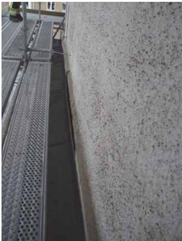
Del av gesimslisten ovanifrån före. Notera utformningen av plåten. VGM_jenbj8_Tidaholms_kyrka_puts_o_plat_2013-03-13_5.jpeg
