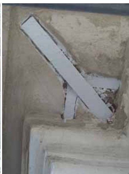
Den numera synliga järnförstärkningen på hörnen under takfoten. Dock syns de inte nerifrån. VGM_jenbj8_Tidaholms_kyrka_puts_o_plat_2013-05-28_4.jpeg
