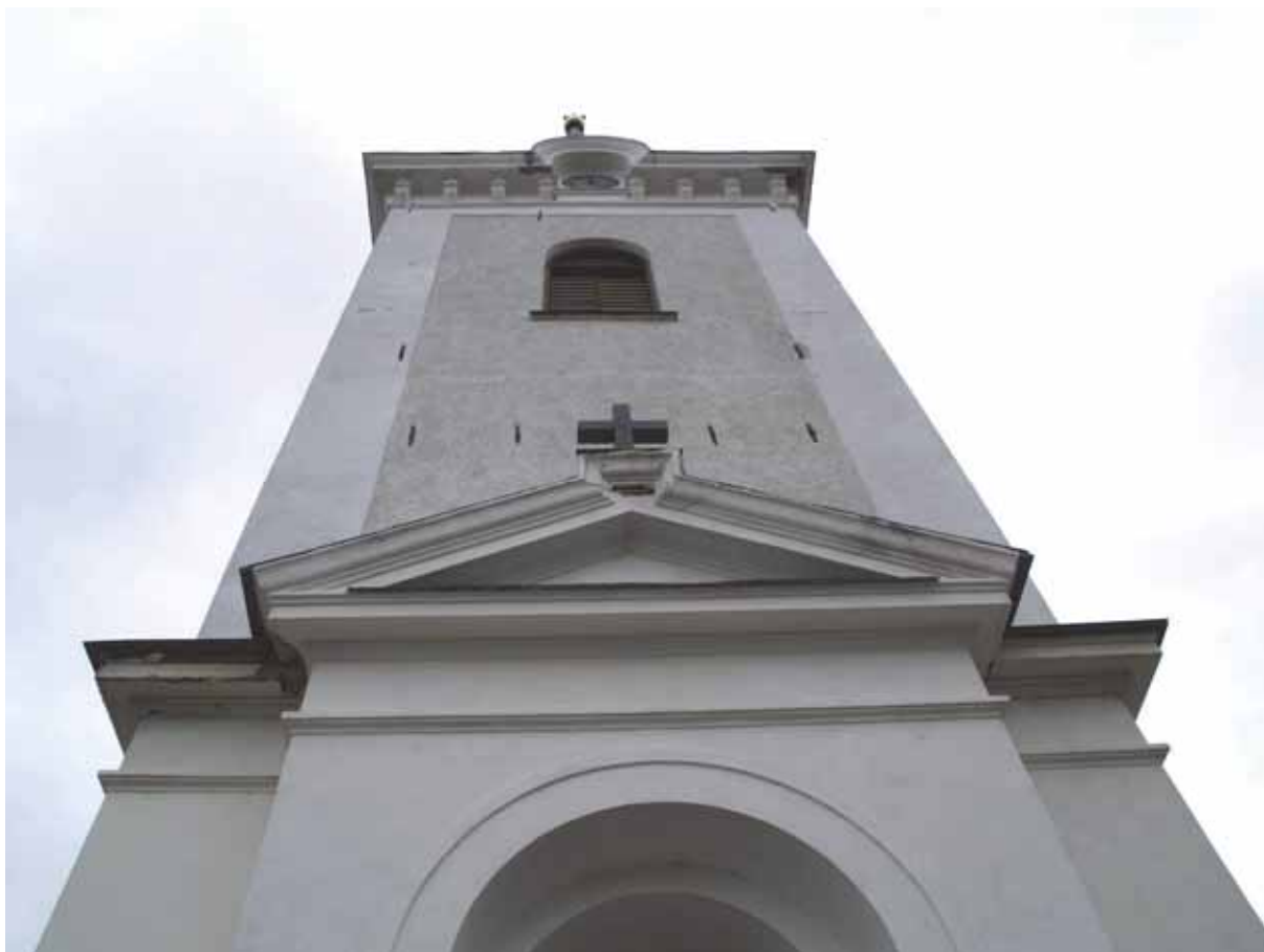
Tidaholms kyrkas torn före åtgärderna. VGM_jenbj8_Tidaholms_kyrka_puts_o_plat_2012-09-05_1.jpeg
