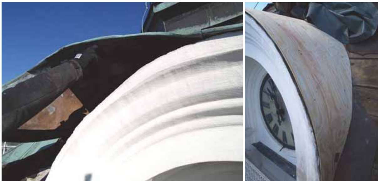
Plåten som låg löst. VGM_jenbj8_Tidaholms_kyrka_puts_o_plat_2013-04-08_1.jpeg
