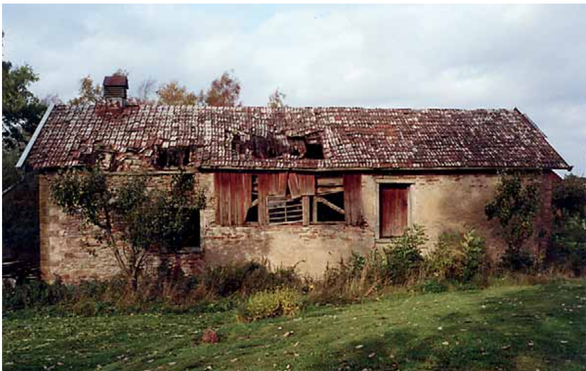
Västerplana mejeri, östra husets fasad mot öster. Allvarliga skador i taket. Okt. 2001.
