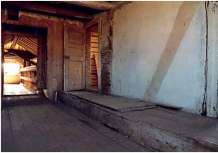
En skada i golvet i förstugan utanför köket...
