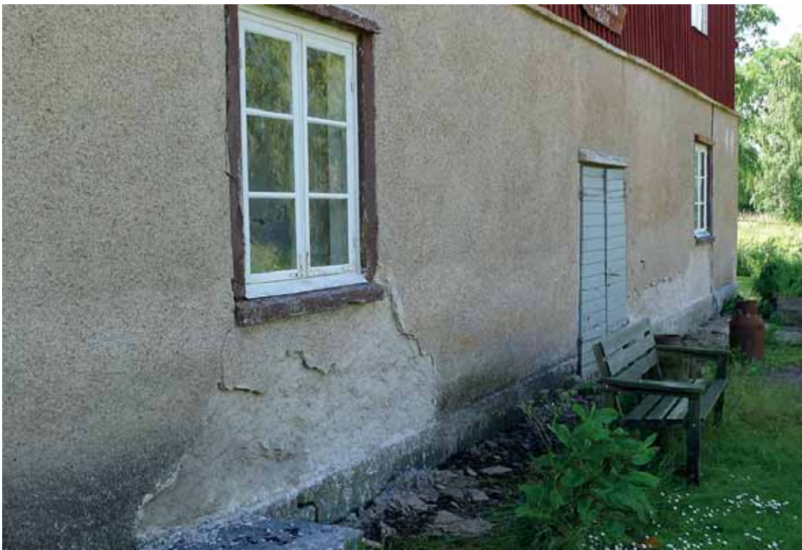
På fasaden mot vägen var inte skadorna lika stora, och en gradvis utstockning räckte för att nå rätt nivå. Juli 2012.
