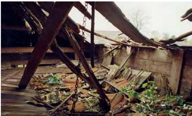
Östra huset, inrasad del av taket. Växtlighet hade slagit rot i rasmassorna. Okt 2001.
