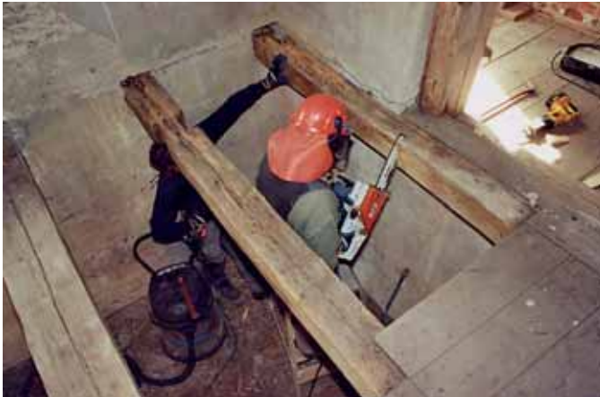
Bjälkarna norr om förstugan hade samma problem - röta vid upplagen i mur. Flera byttes eller iskarvades. Sept. -07.
