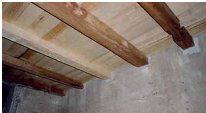
Samma bjälklag som ovan, med nytt golv sett underifrån. Alla upplag isolerades med näver där det gick att komma åt. Okt -07.
