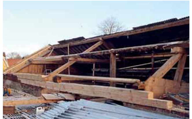
Byte av åsar (den närmaste) och förstärkning med plank (den bortre). Nya hammarband vilar på ett par utjämnande tegelskift. Nov. 2002.
