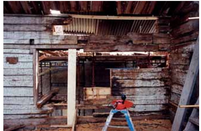
Allt rötskadat virke togs bort i östra väggen på magasinstrymmet. Sep. 2002.
