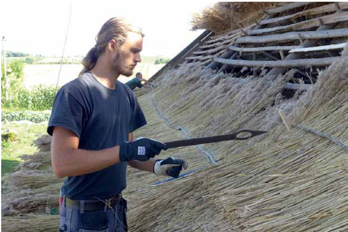
Där det äldre halmlagret sparades på norra takfallet blev strålagret så tjockt att det krävdes en annan typ av nål med bakstickare på insidan av taket, 2013-09-03. Foto: Ulf Larsson.
