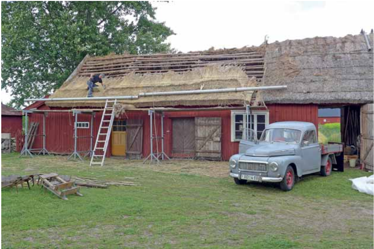
Omläggning av det södra takfallet har påbörjats, 2013-08-20. Till höger i bild syns det befintliga vasstaket, där de blottade täckespröten framträder som horisontella linjer. Foto: Ulf Larsson.
