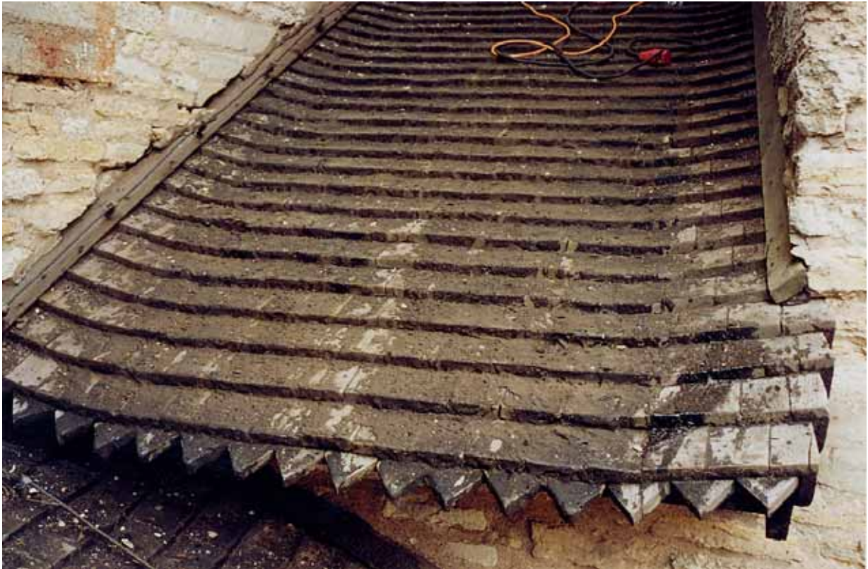
Tak 32 - exempel på spån som strukits med stenkolstjära, ev. på 1960-talet. Aug. 2004.
