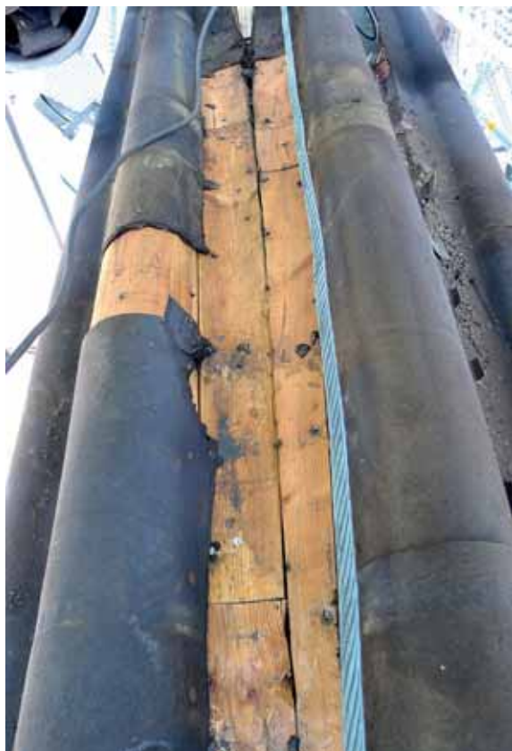
Parti högt upp på södra tornet, med utbytt virke från 1940-talet. Samtida underlagspapp. Juni 2012.
