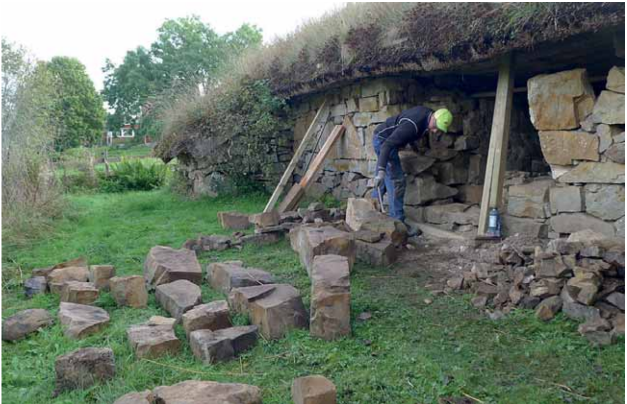
I samband med att stenarna togs ned stämpades takets långband för säkerhets skull. Sept. 2015.
