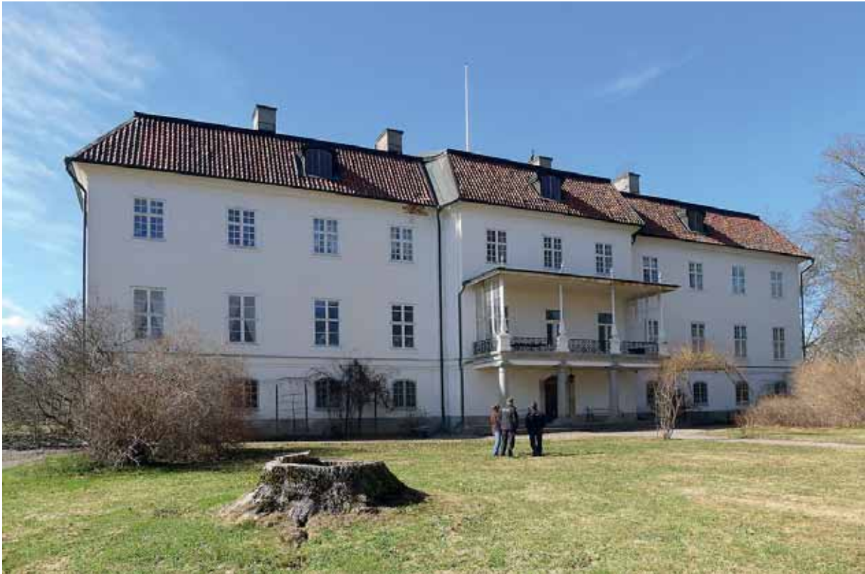
Almnäs, fasad mot Vättern. Skada i taklisten alldeles till vänster om risaliten. Foto april 2013.
