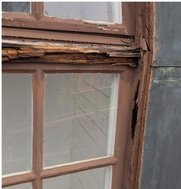
Bild ovan: skador på takkuporna. Foto: Mattias Landahl.
